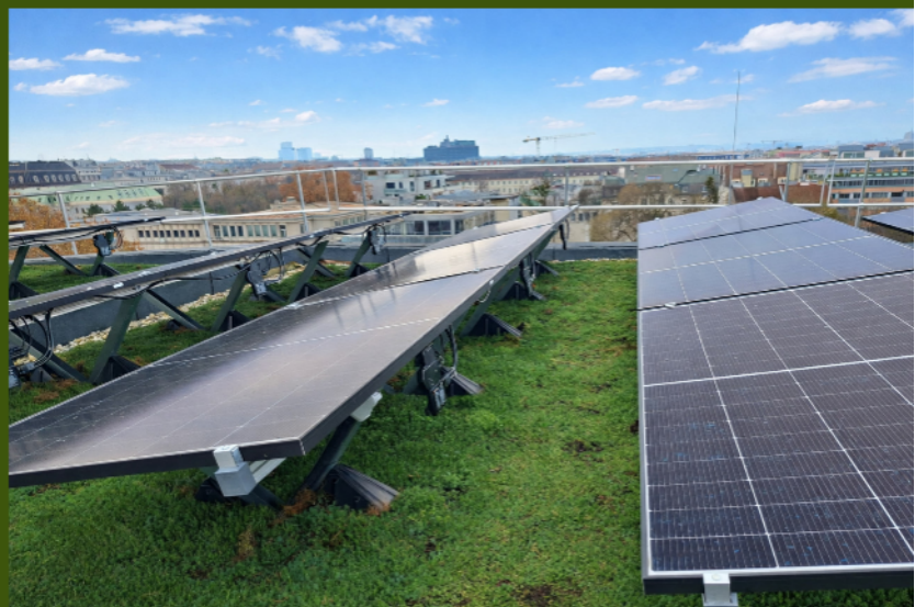
Foto: PV –Gründach
