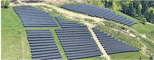
Photovoltaikanlage in Bromberg zur Stromproduktion
