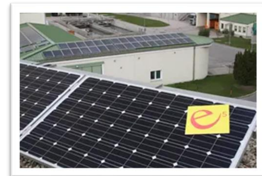
PV Anlage der Stadtgemeinde
